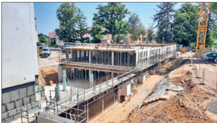
Ein Blick auf die Baustelle am Klinikum Mittweida verrät: Die Baumaßnahmen für den Pflegeersatzneubau, in welchen auch die Geburtshilfe einziehen wird, schreiten planmäßig voran. (Foto: Ines Schreiber/LMK)
