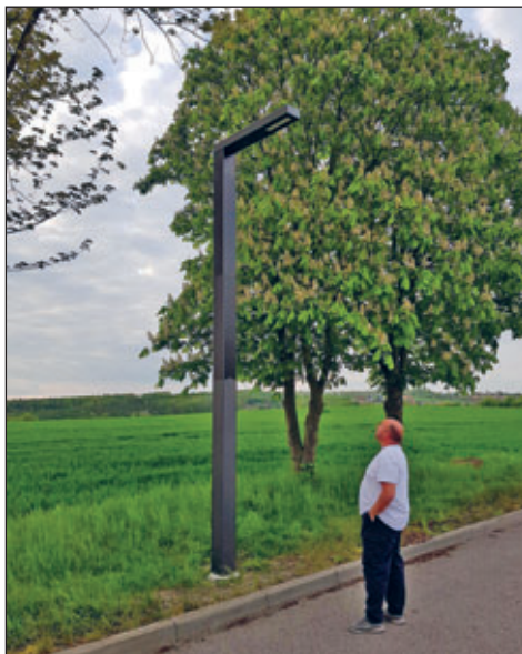
Besichtigung einer Solar-Mastleuchte in Geringswalde
