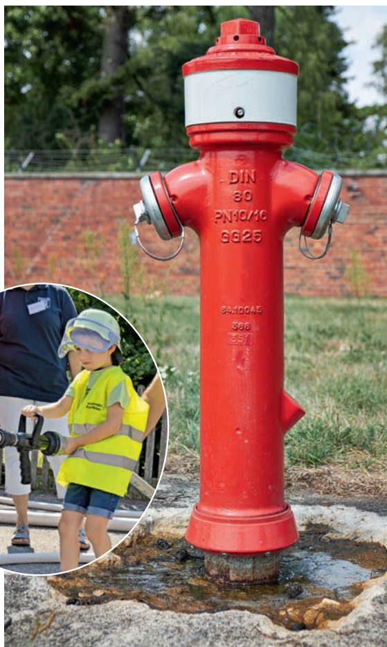
Tank leer? Ein Hydrant muss her!
