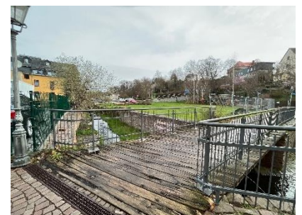
Blick auf die Brachfläche östlich des Altmittweidaer Baches mit der desolaten Fußgängerbrücke im Vordergrund
